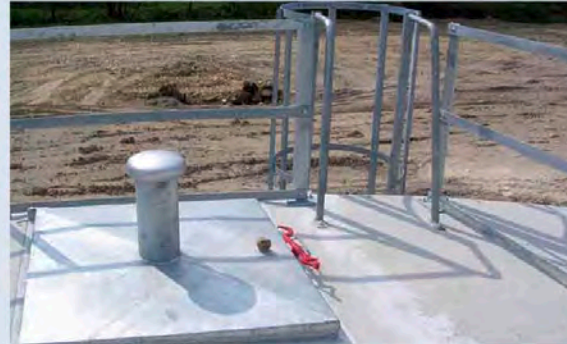
Accès au réservoir avec garde-corps sur la dalle de couverture et trappe d'accès
