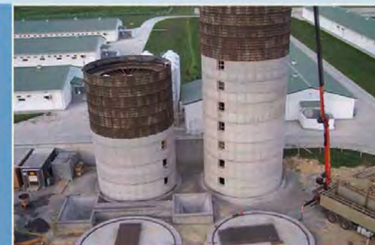
Silos de stockage biomasse avec radiers et portes
