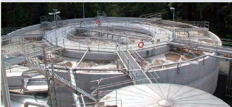
Bassin de station d'épuration avec bassin d'aération et paroi intérieure
