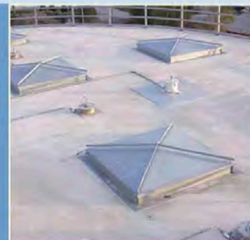
Dalle de couverture du silo avec dispositifs d'explosion et de sprinklage
