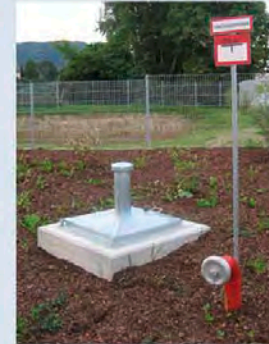
Couverture de regard avec aération Tuyau d'aspiration et panneau de signalisation
