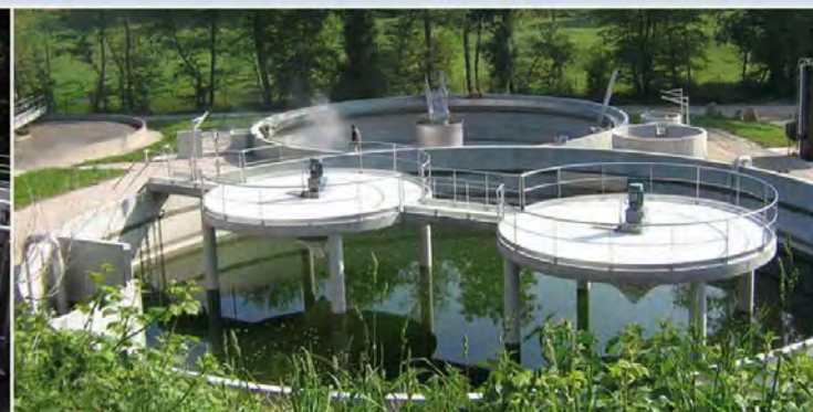
Bassin d'aération avec équipement spécial
