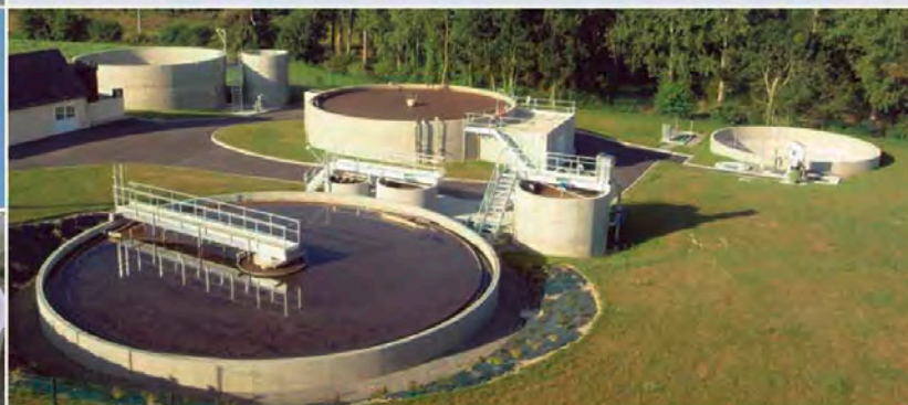
Station d'épuration urbaine
