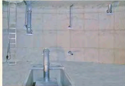
Vue intérieure d'un sprinkler
